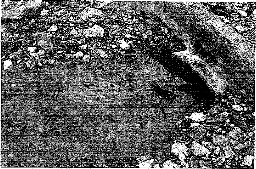
180101-04-17- Bahía del Club Náutico. Desagüe pluvial "A". Presencia de hidrocarburos.
